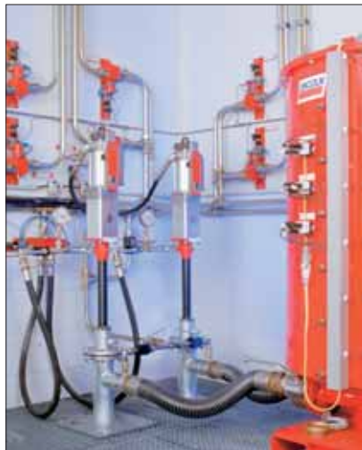
Смазка при помощи контейнерного насоса
